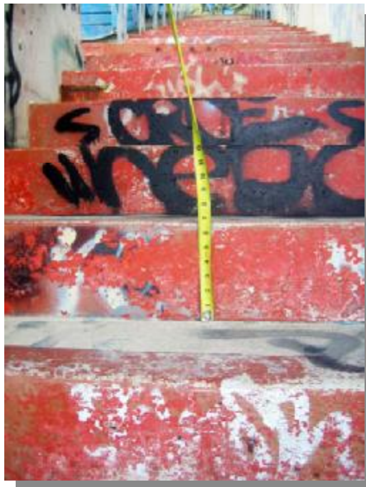
10- Stair Riser 7" High
